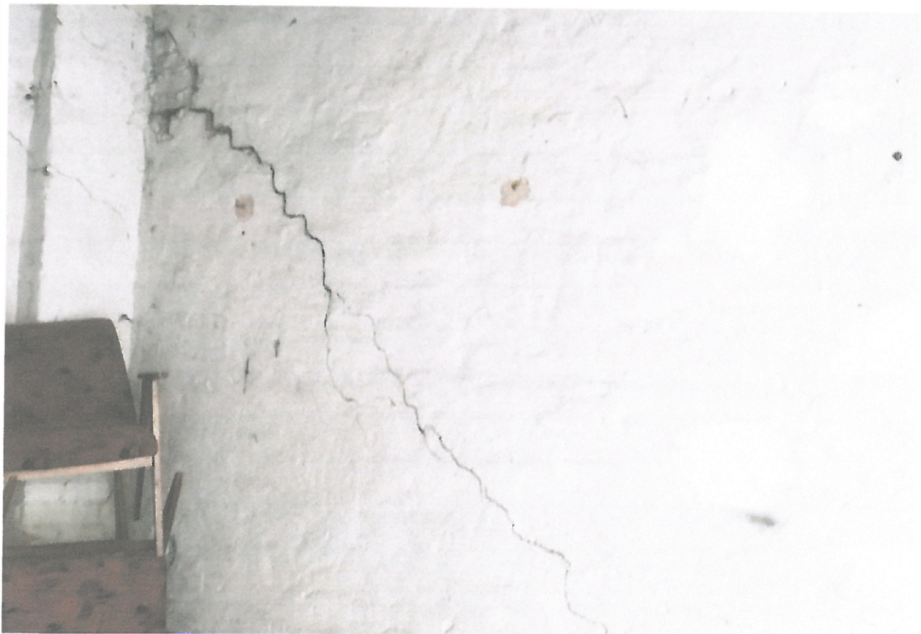
Pęknięcie ściany poprzecznej w garażu niskim.
